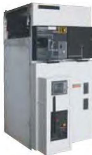
Celda de interruptor automático.
