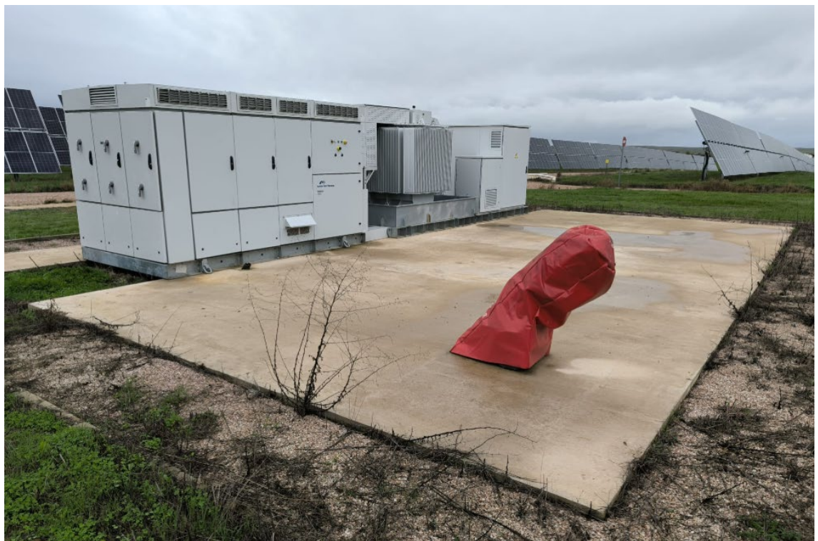
Ilustración 37.- Losa existente junto a los inversores de Power Electronics
