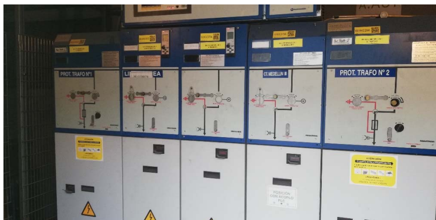
Celdas existentes en el CT “Medellín 1 (T)”
