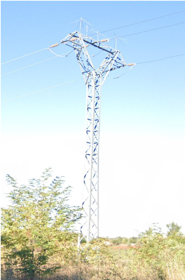
APOYO Nº 17 LAMT "MOHECILLA" DERIVACIÓN
