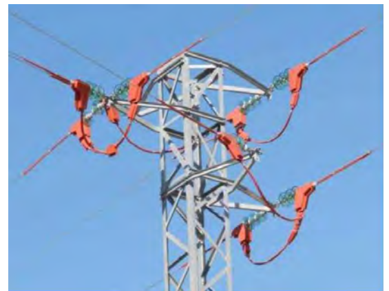
Ejemplo de protecciones instaladas
