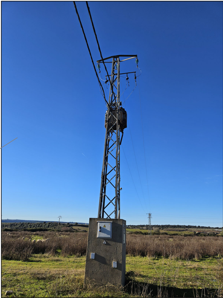
CENTRO DE TRANSFORMACION AEREO MOHECILLA
