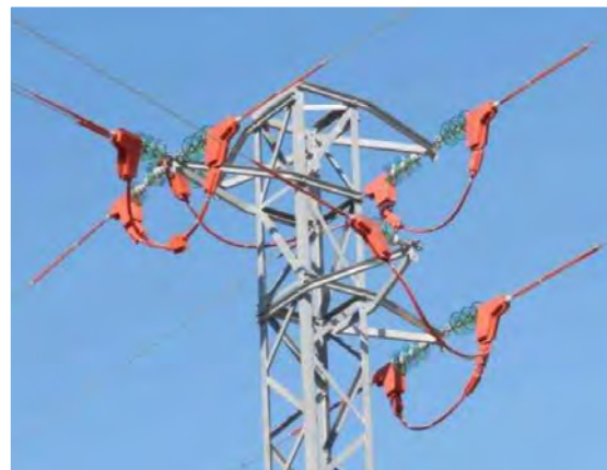
Ejemplo de protecciones instaladas
