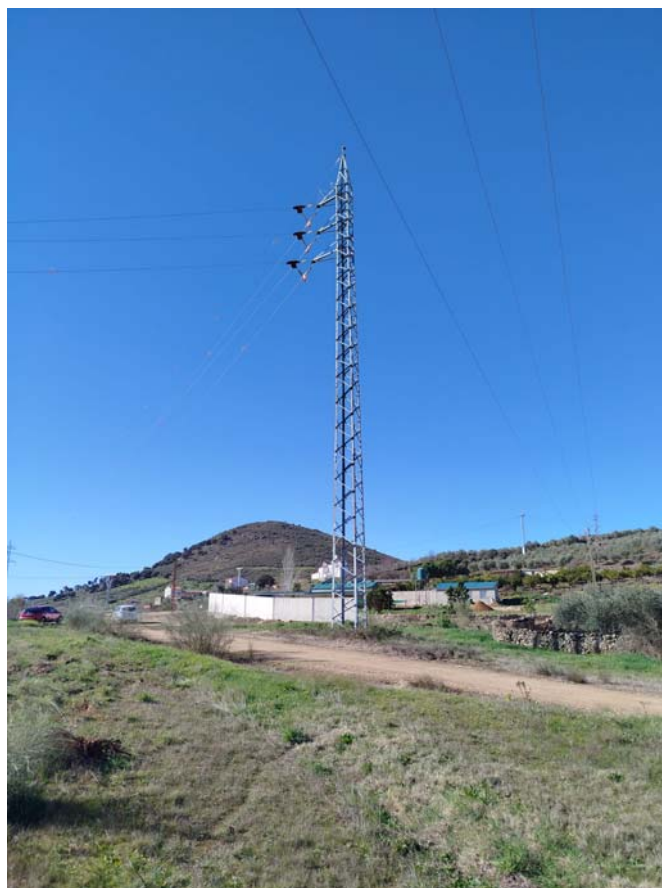
Apoyo 5180 a mantener de la LAAT “Abertura” donde se realizará un entronque A/S
