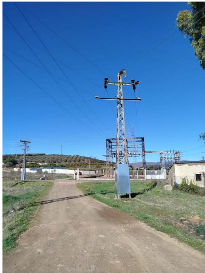
Apoyo 5182 a mantener de la LAAT “Cañamero”
