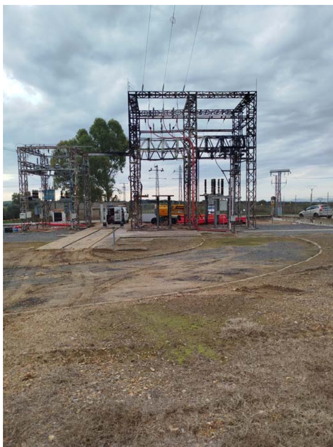
Entrada a STR ‘Logrosán’ línea aérea “Abertura”
