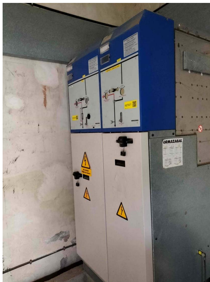
Celdas existente en el CT "Poblado Valdecañas"
