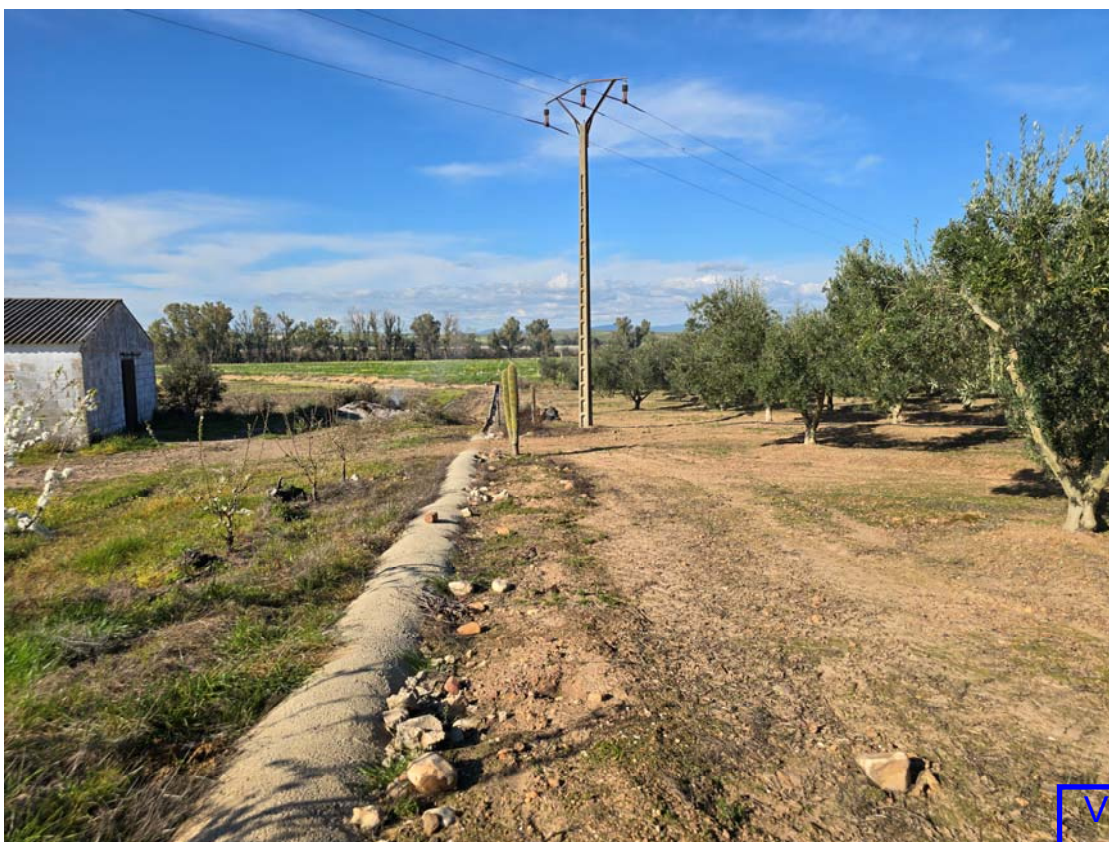
Apoyo 2058 de la LAMT “Fernando V” a mantener
