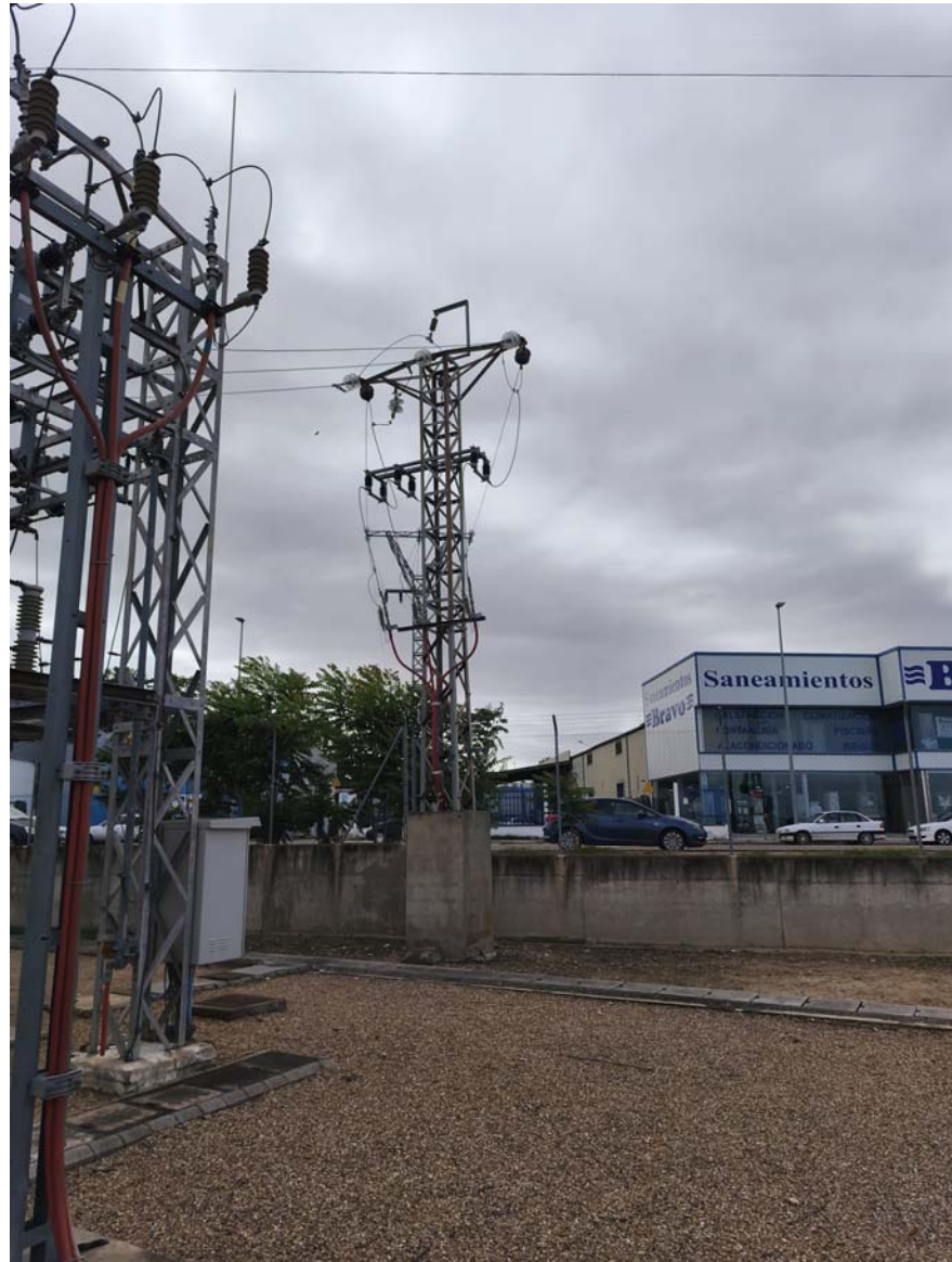
Apoyos 5000 existente de la L-4870-02-“Centro E.E.”
