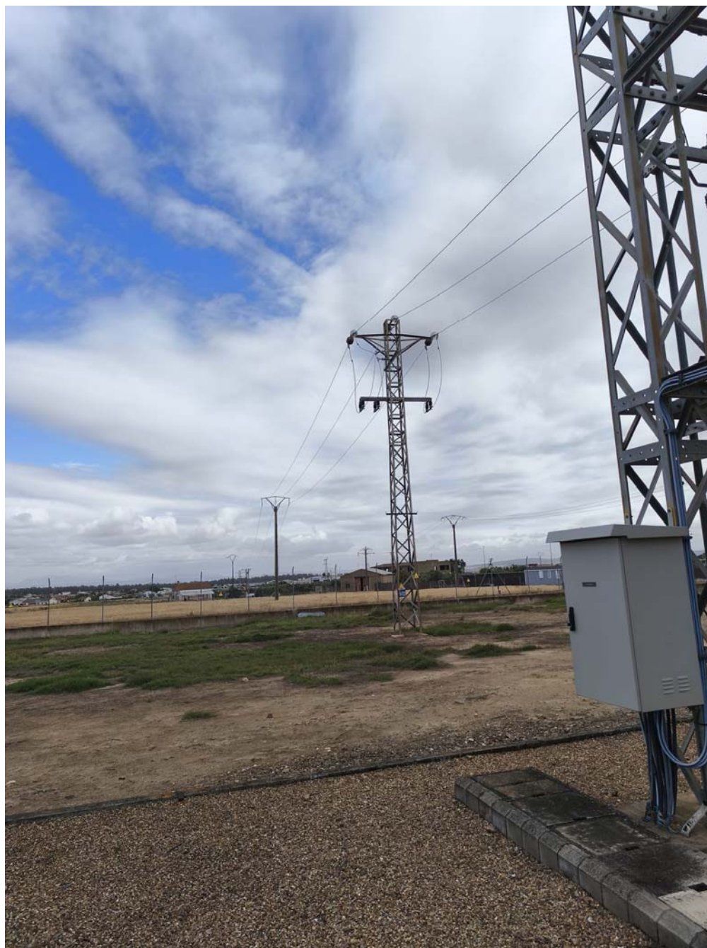
Apoyo existente 5001 de la línea 4870-09-“Consiber” a mantener
